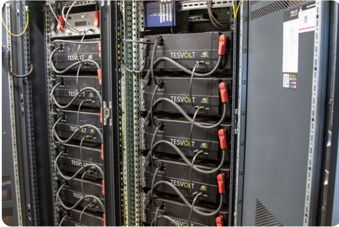
Großdimensionierte Stromspeicherbänke sorgen bei „Priogo“ dafür, dass der durch die Sonnenkollektoren erzeugte Strom auch genutzt werden kann, wenn die Sonne gerade nicht scheint. Bild: Tameer Gunnar Eden/Eifeler Presse Agentur/epa
